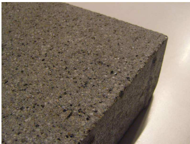
Płyta „brukowa”, nierówność j.w.
